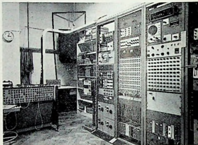
Een stel zgn. kruisborden waarmee elke gewenste schakeling is op te bouwen (zie RB jan. '72).
